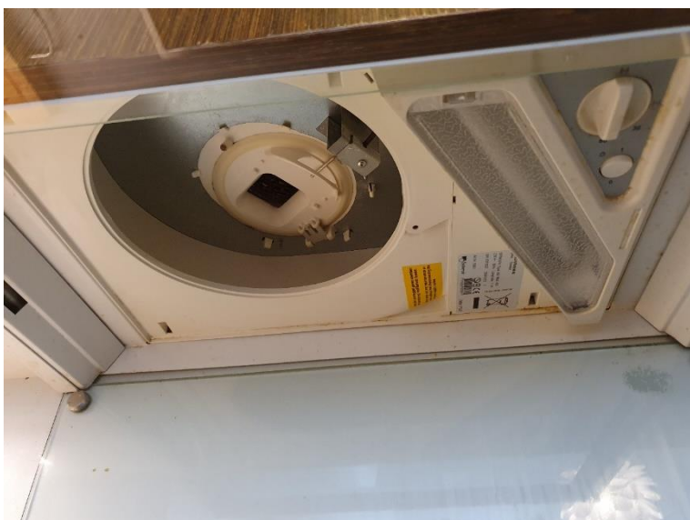
Figur 10: Luftehullet i spjeldet er nå åpent
